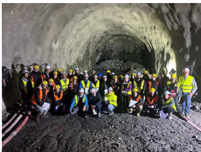
Έργα του συστήματος αντλησιοταμίευσης Αμφιλοχίας
